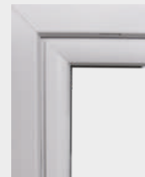
Désaffleure de l'ouvrant
