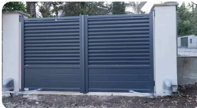
Portail battant motorisé : un moteur par vantail, au pied de chaque pilier.
